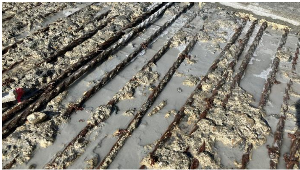
Abb. Nr. 6: Stehendes Wasser muss entfernt werden
